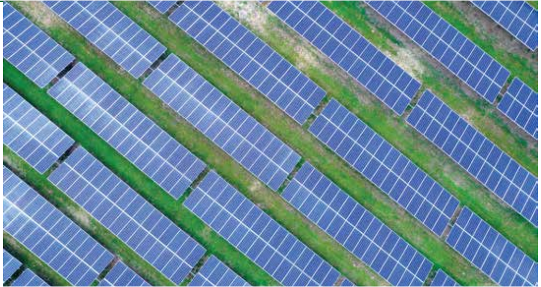
Usina solar instalada em São José dos Campos - SP
